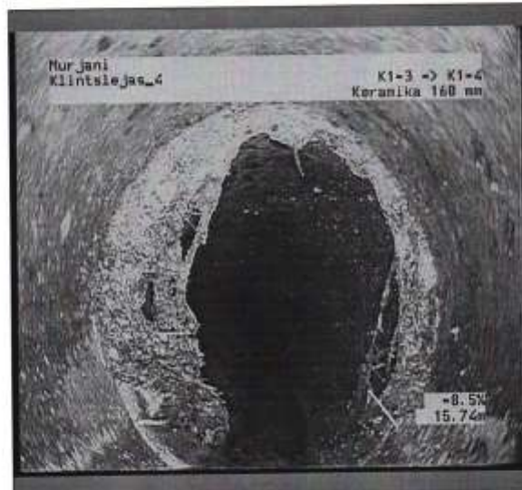
Fotoattēls: K1-3_K1-4_3_4_A.JPG, 00:01:57 15,74m, Sīkas saknes, caurules diametra samazinājums Diametra samazinājums: 3 %, no 12 līdz 11 st., Savienojumā
